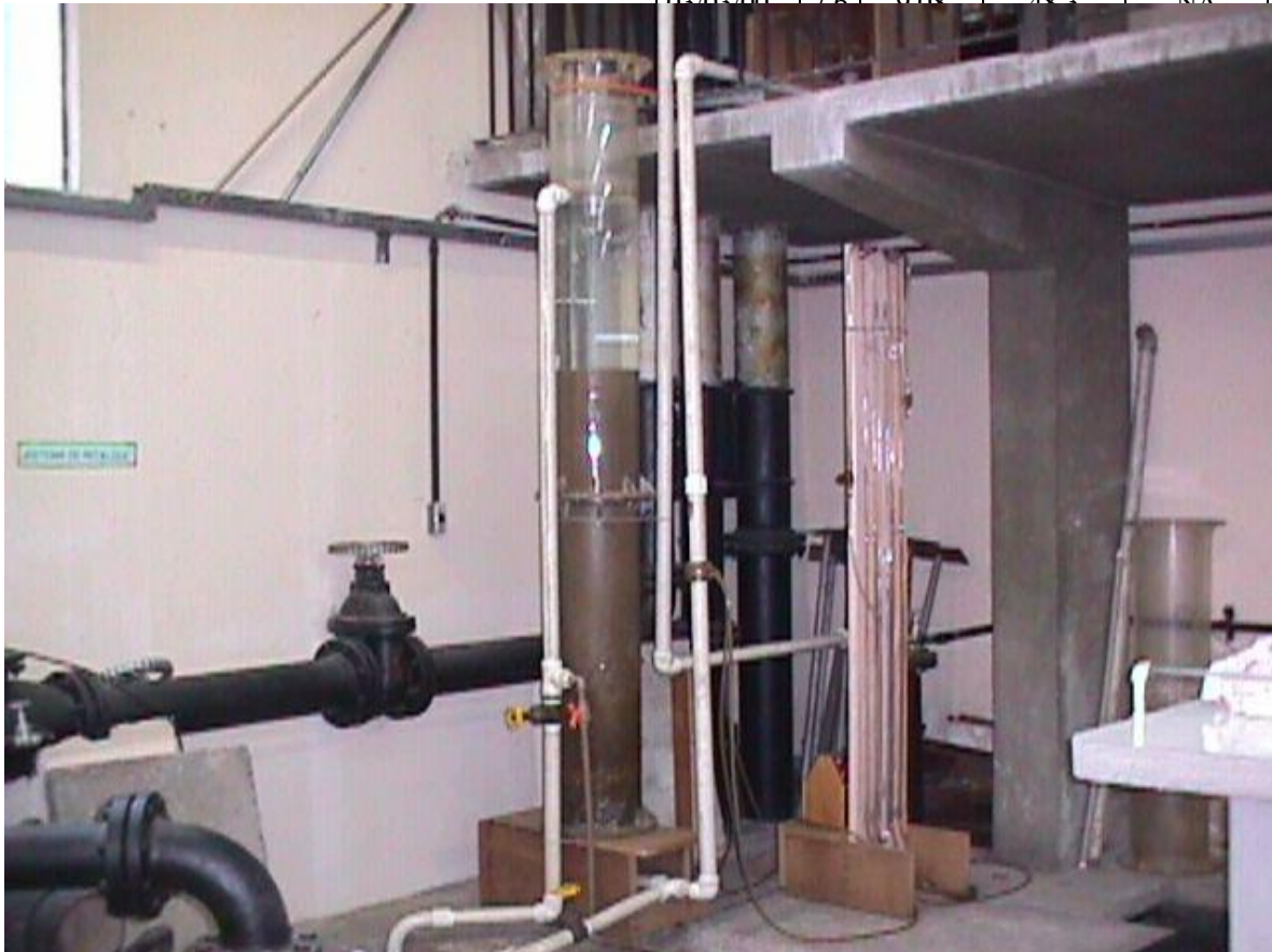
Figura 6 – Vista do sistema de filtração mostrando o leito filtrante e as tubulações de alimentação com água coagulada e de coleta de água filtrada
