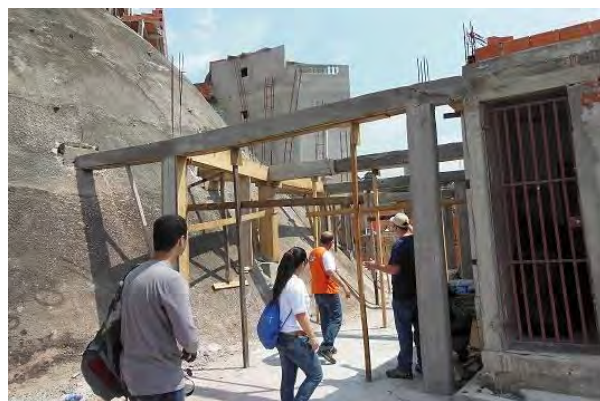
Figura 2 – Construção irregular em área reurbanizada da comunidade do Jaguaré, São Paulo - SP.
