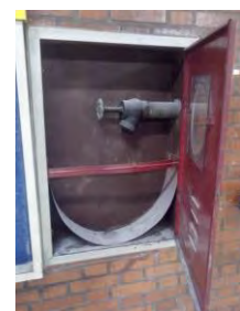
Figura 3 – Caixa de Hidrante sem Mangueira e Acessórios.
