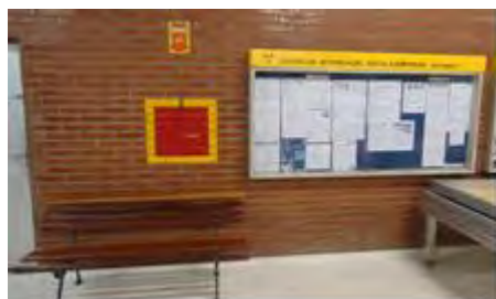
Figura 1 – Equipamentos de Proteção Contra Incêndios (Extintores).
